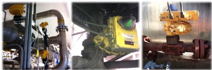
【水処理プラント】
